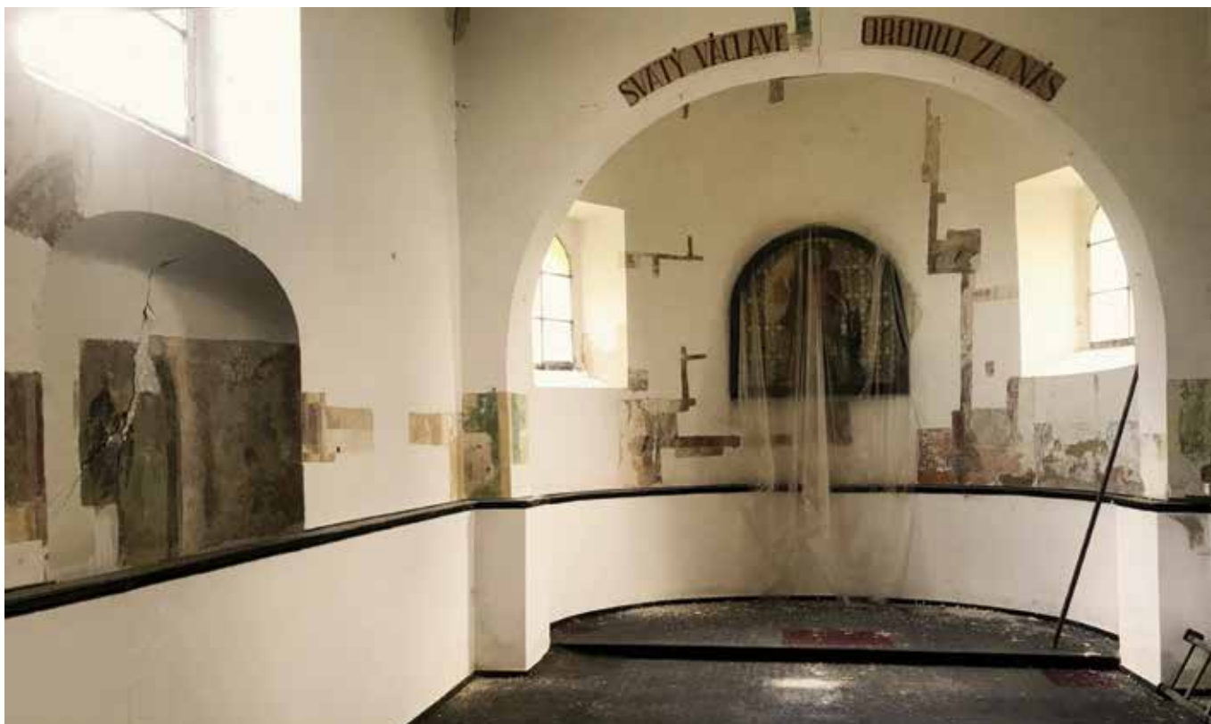
Obr. 3. Interiér kaple před zahájením stavebních prací. Na první pohled je patrná zcela zbytečná a hyzdící obezdívka s jakousi (nefunkční) větrací dutinou (foto F. Chmel, 2020).
